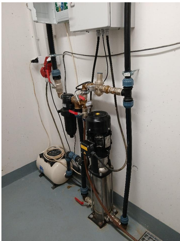
Obr. 3: strojovna závlahového systému v suterénu bytového domu
